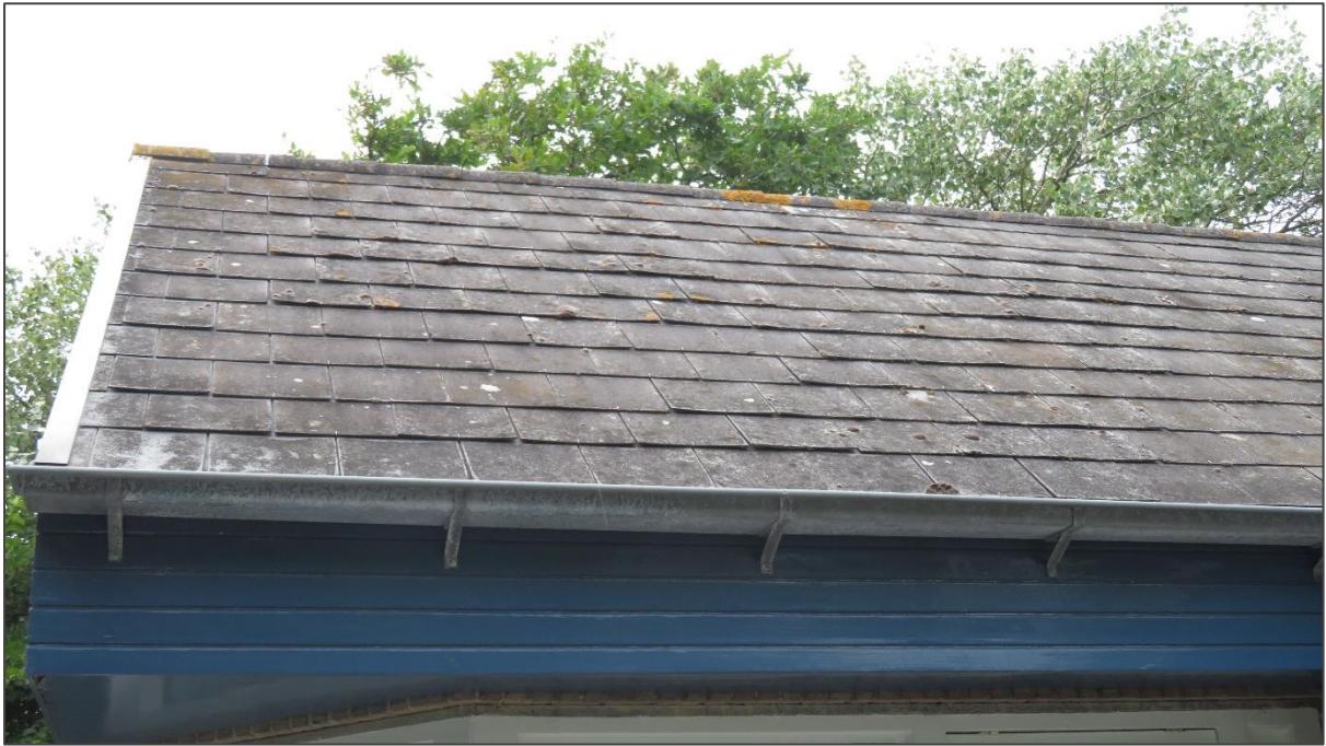
Afb 14: Geen mogelijkheid voor vogels om onder de dakbedekking te komen
