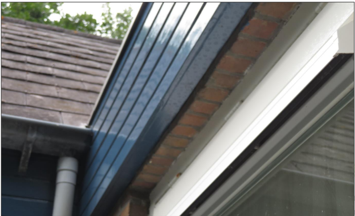
Afb 15: Aansluitingen sluiten strak aan op het gevelmetselwerk. Geen mogelijkheid om in- en uit te vliegen
