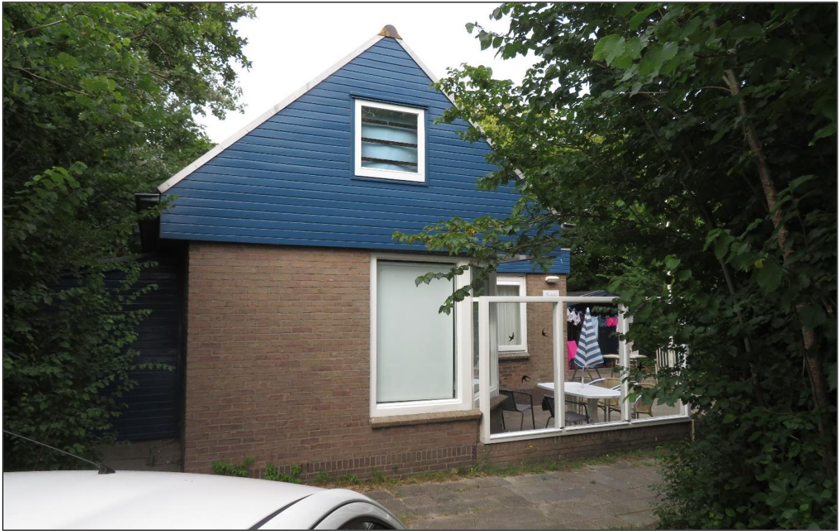
Afb 17: Open stootvoegen in metselwerk ontbreken
