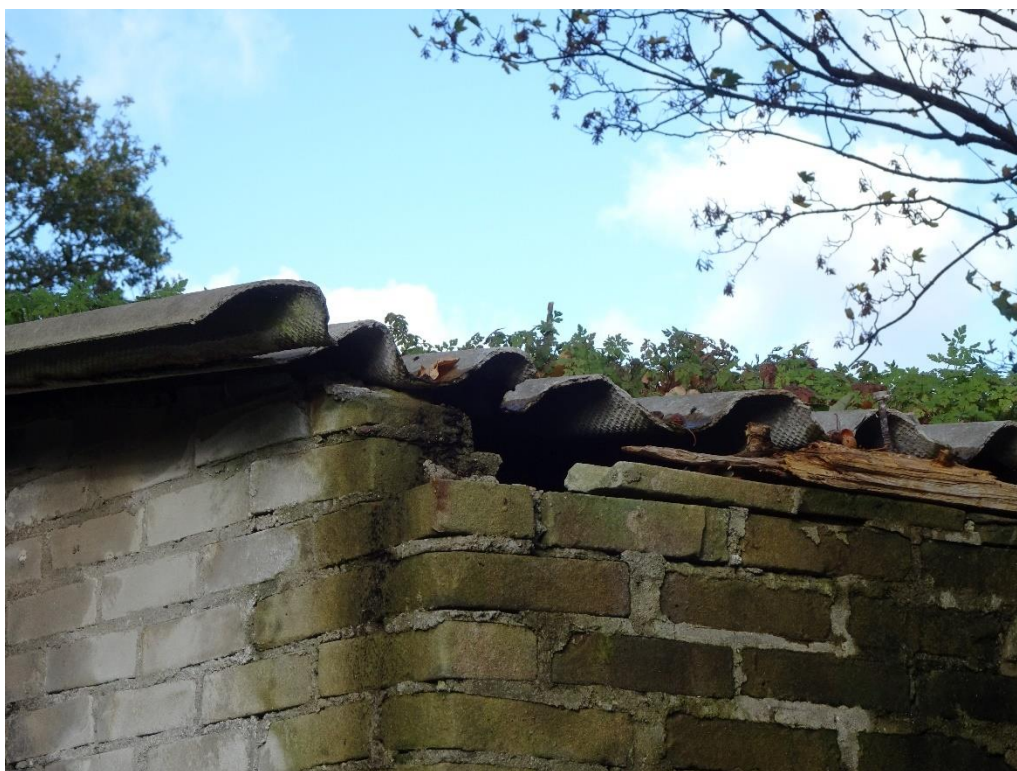
Het aanwezige gat in het dak van de schuur.
